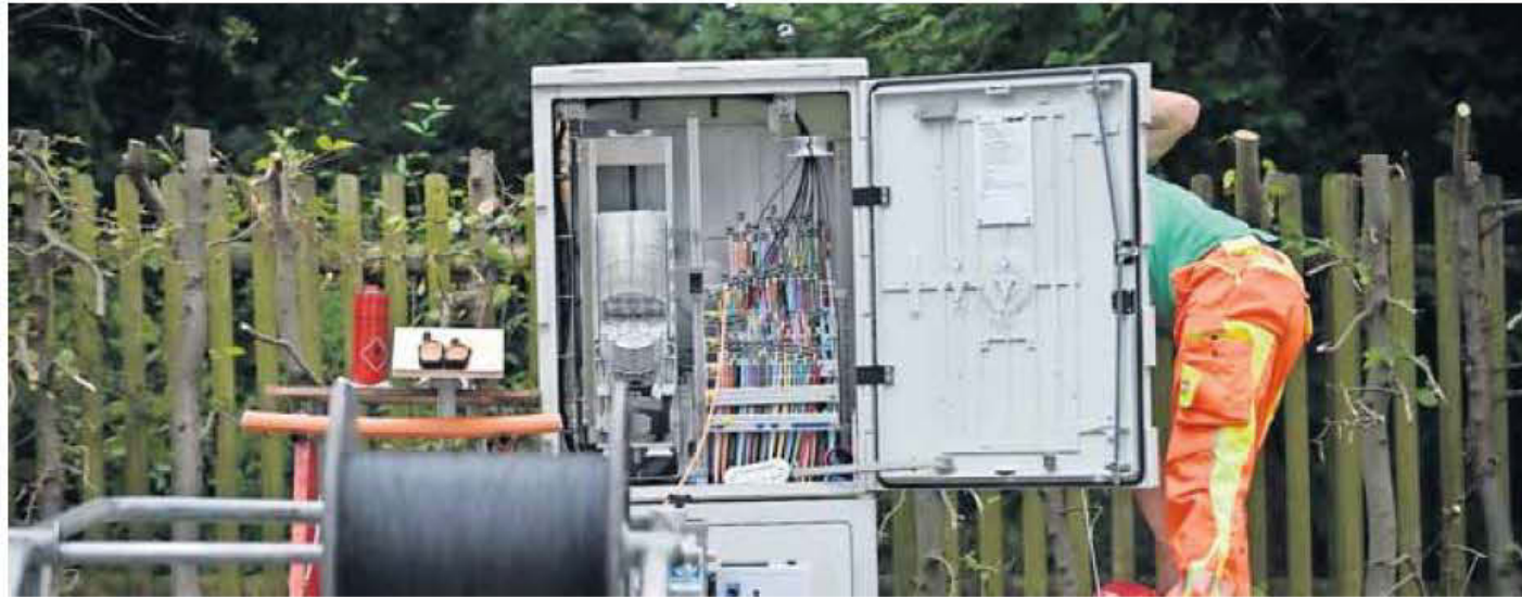
Ein Verteilerkasten für Glasfaserkabel in Sachsen-Anhalt.
